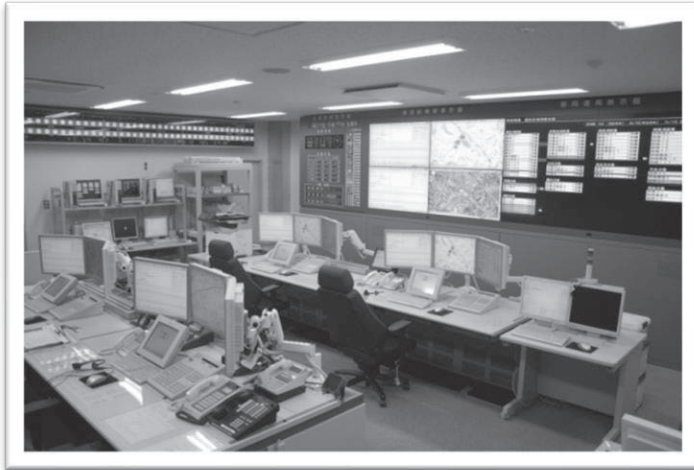
高機能消防指令システム
