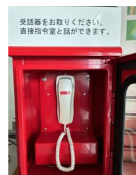
駆け込み通報装置
